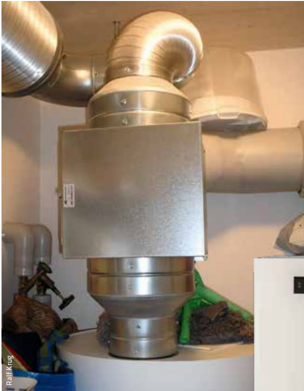
Abbildung 4: Abluft-Wärmepumpe in einem Abstellraum
