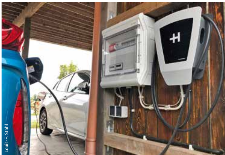
Zusätzlich zum Preis der eigentlichen Wallbox fallen Kosten für die fachgerechte Installation und gegebenenfalls eine notwendige Modernisierung der Unterverteilung an.
